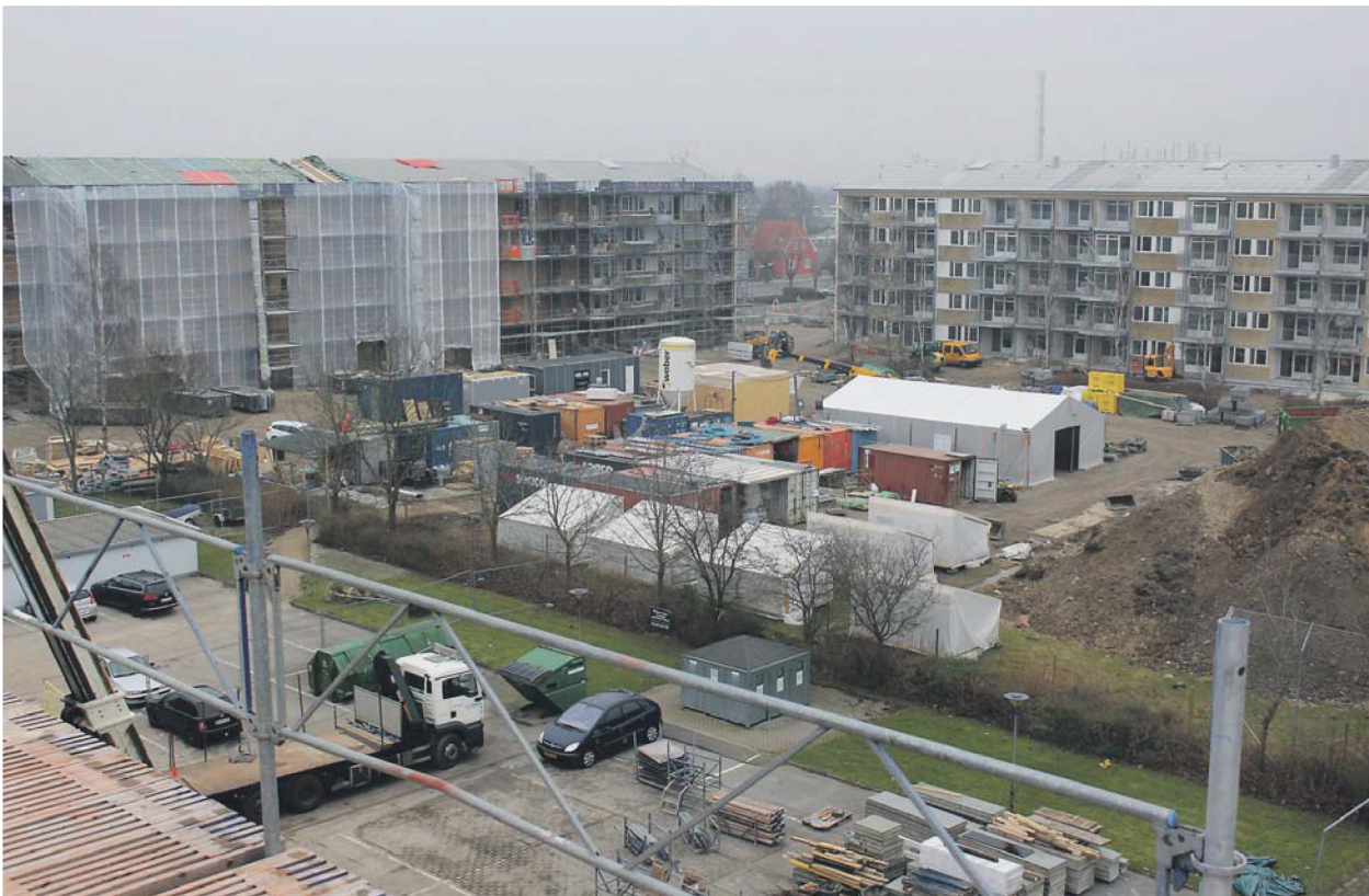
Overblikket får man af indlysende årsager bedst fra oven, så Lokalavisen Odense gik med projektlederen på taget. Første etape af renoveringen er færdig til december - resten af Korsløggen står klar i 2020.
